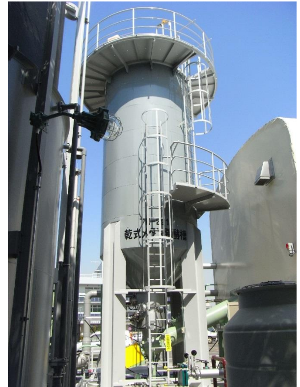
乾式メタン発酵槽
