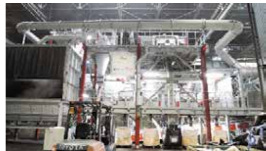
写真2 トレンゾラインの全体写真
