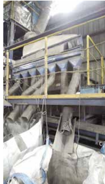
写真1 エアテーブルによる比重選別 エアテーブルでは写真右端の重量物と左端の軽量物に分離するだけでなく、中央のホースから出る中間の比重を持つ焼却残渣は再度投入し、回収率を上げている。
