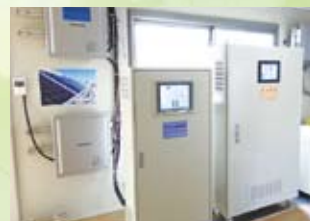
▲水素蓄電を研究するための実験システム
