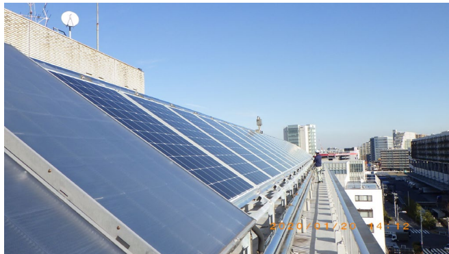
太陽光発電装置(8kW) ※当研究所本棟屋上に設置
