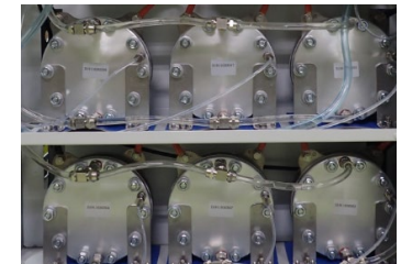
盤内の水電解ユニット
