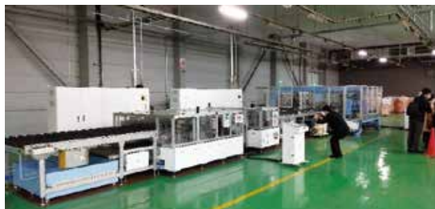
太陽光パネルリサイクル設備
