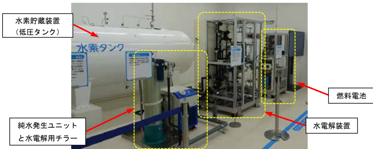
図4 水素発生装置室内の水素蓄電構成機器の設置状況
