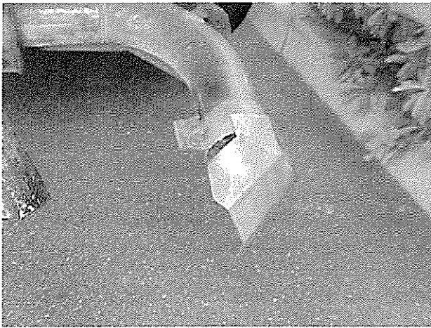
図3 排気管出口の拡散板
