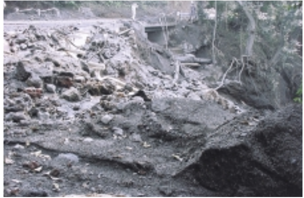
写真1 泥流による道路の決壊 (2000/9/19)
