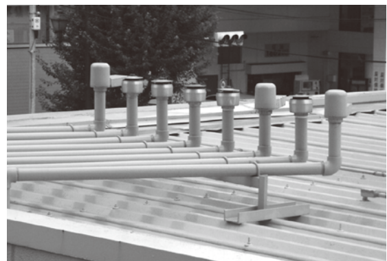
地下タンクの通気管
