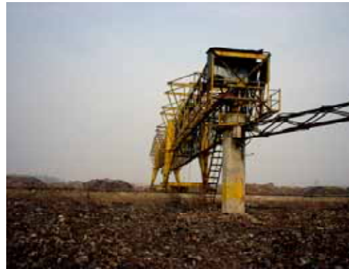
[コンポスト処理場（レーキ攪拌機）]
