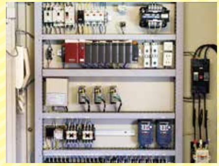
昇降機制御盤
